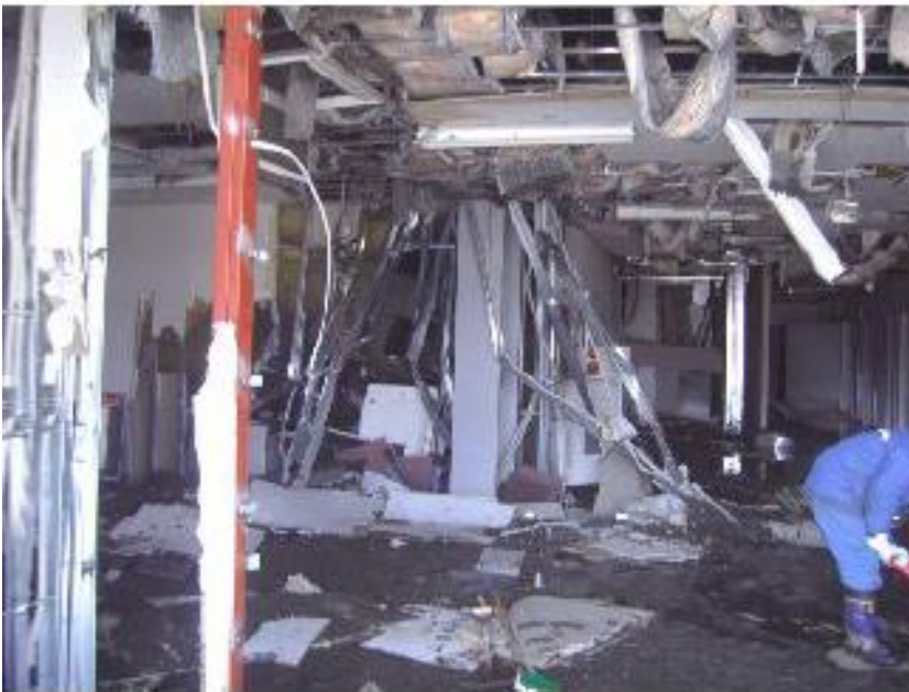
【全冠水し損壊した事務本館1F】
