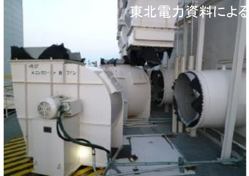
【引きちぎられた設備(ファン)】
