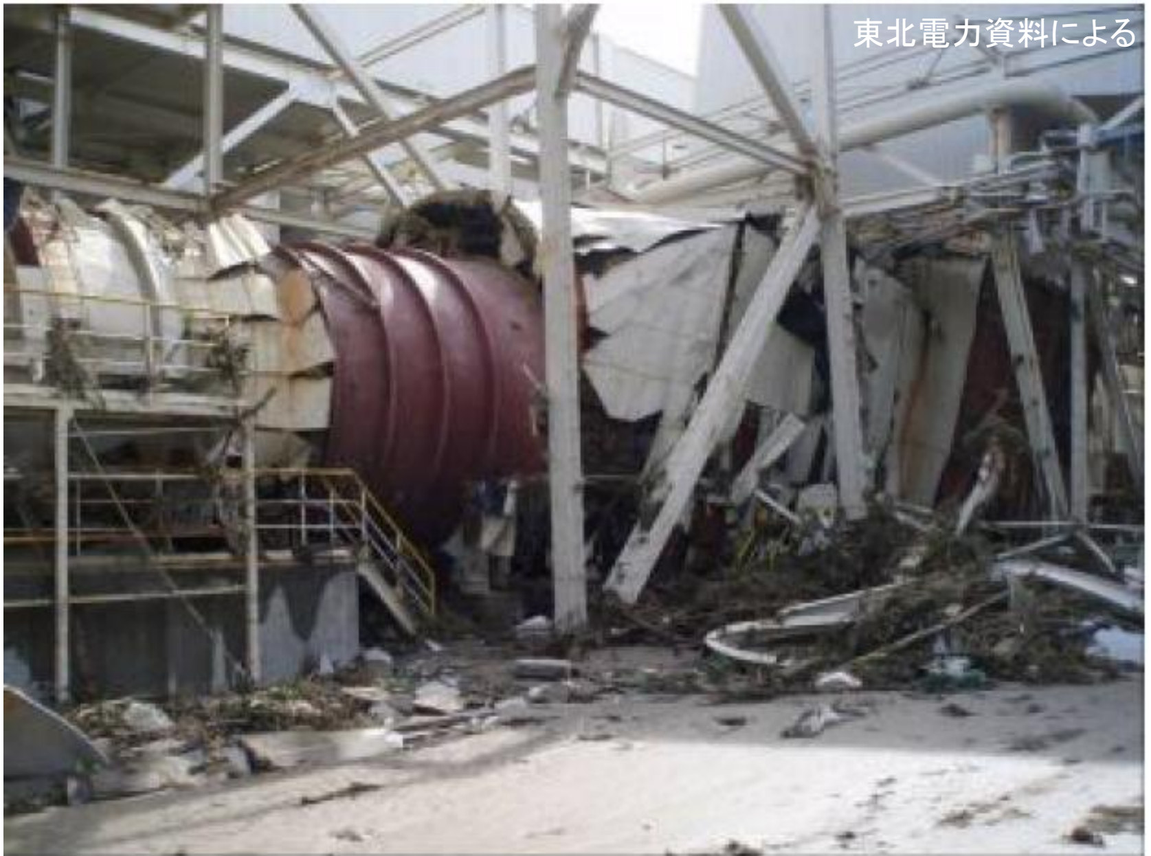
【損壊した大型ファン(誘引通風機)】
