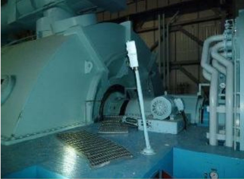
【芯ずれが懸念されるタービン-発電機】
