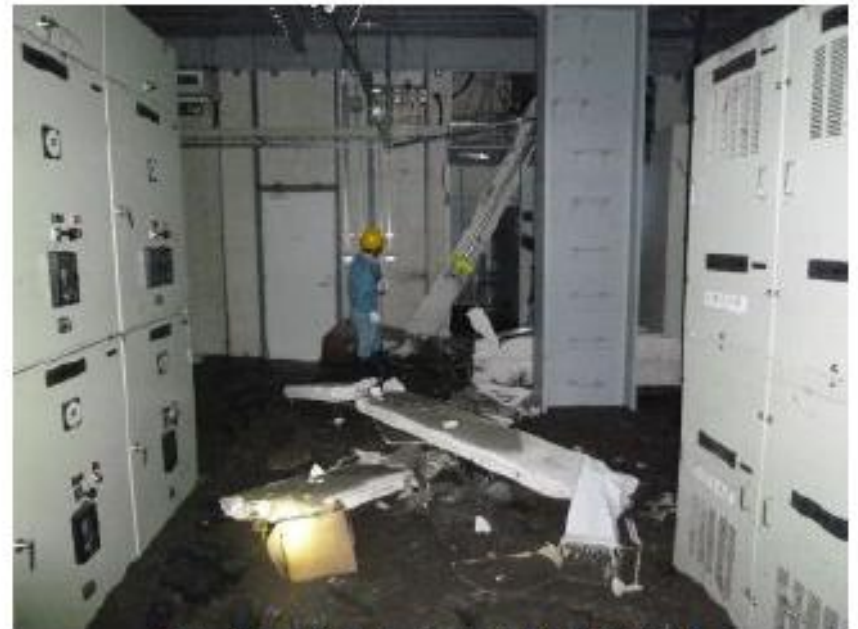
【土砂が流入した電源盤室】
