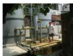
図8. ベトナムに設置した地下水中 砒素除去施設
